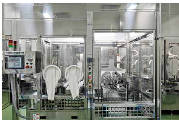
【充填室】 充填設備
