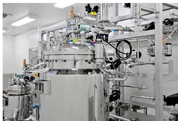
【調液室】 調液設備
