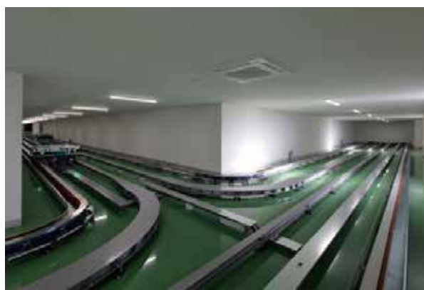
【物流】起動台車レール
